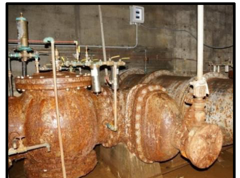
Válvulas de túnel que deben repararse
