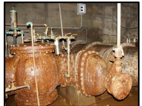
隧道阀门需要维修
